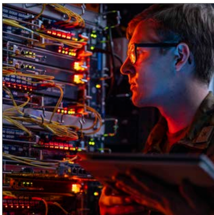
Contrôle des systèmes de transmission optiques
