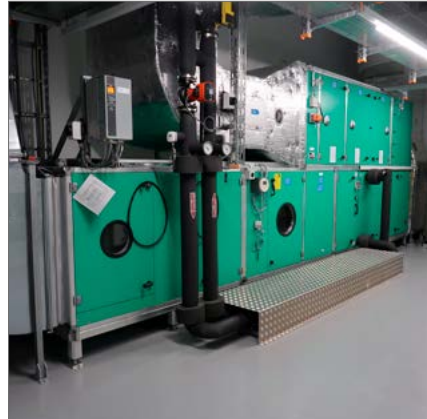
Centrale de ventilation moderne
