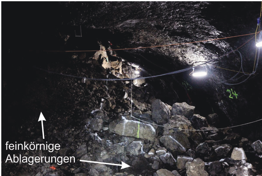
Bild A1-5: Schuttböschung im Bahntunnel zwischen den Kammern 10 und 12
