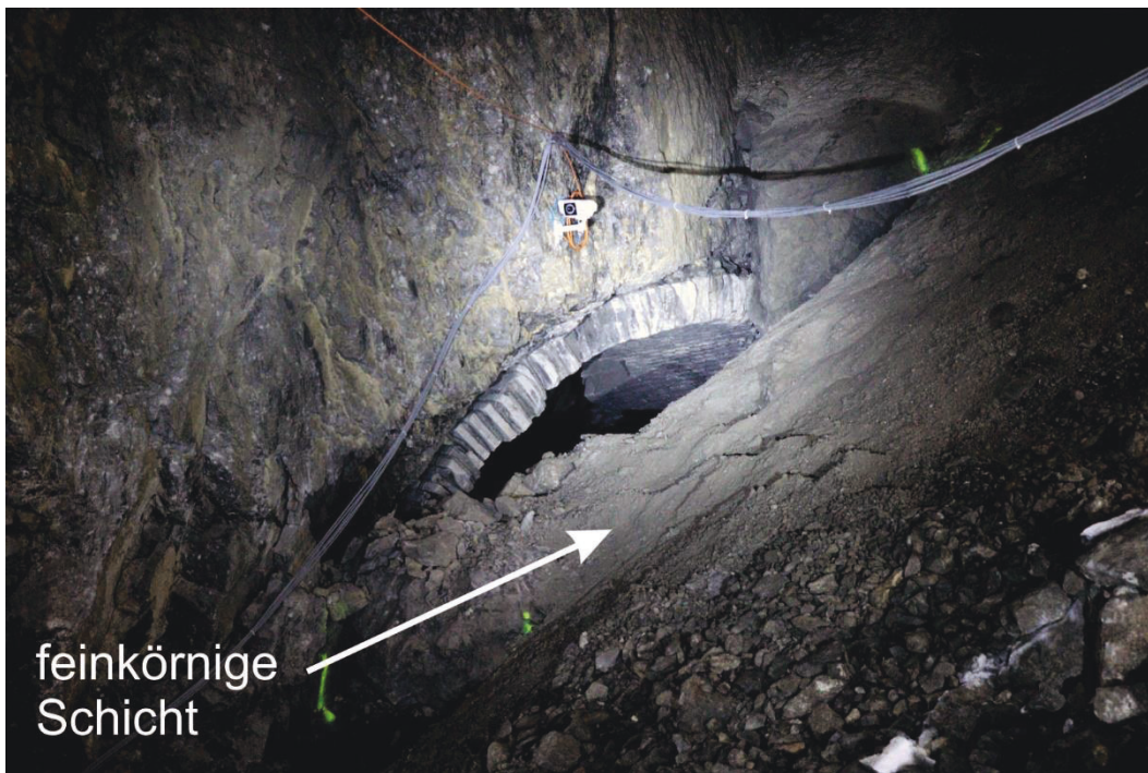
Bild A1-6: Schuttböschung im Bahntunnel zwischen den Kammern 10 und 12
