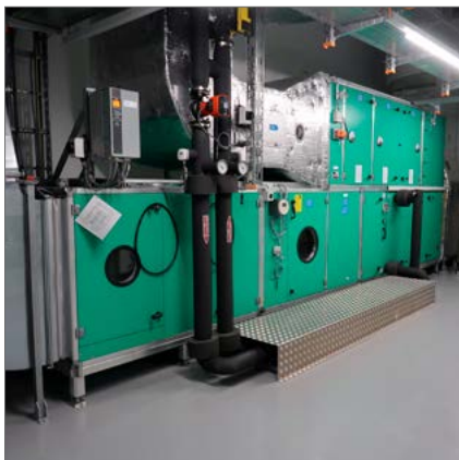
Centrale de ventilation moderne
