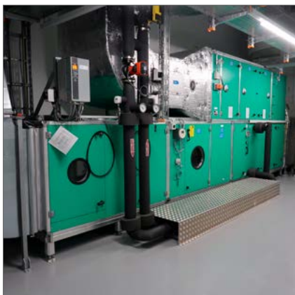
Moderna centrale di aerazione
